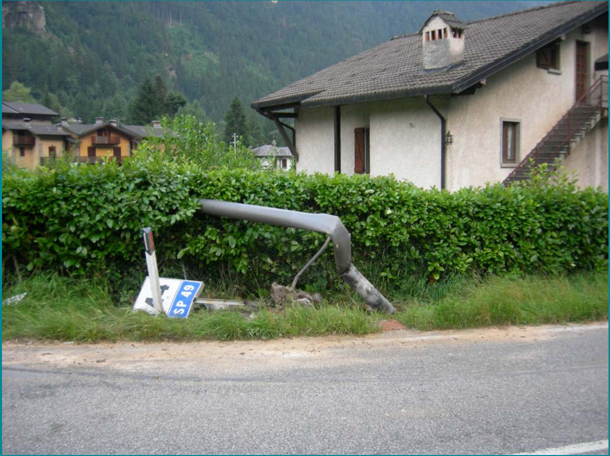
100LE3 lichtmast aangereden in de provincie Bergamo, Italië.
